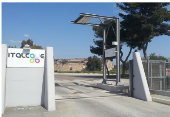
Fig. 25 - Portale radiometrico all'ingresso dell'impianto
